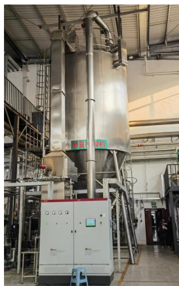
生产车间内部
