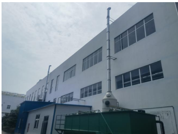
真空泵尾气喷淋吸收塔及排气筒
