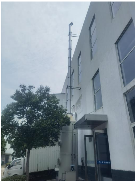
出渣废气喷淋吸收塔及排气筒
