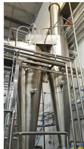
喷雾干燥塔旋风除尘器
