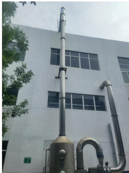
喷雾干燥废气水喷淋吸收塔及排气筒
