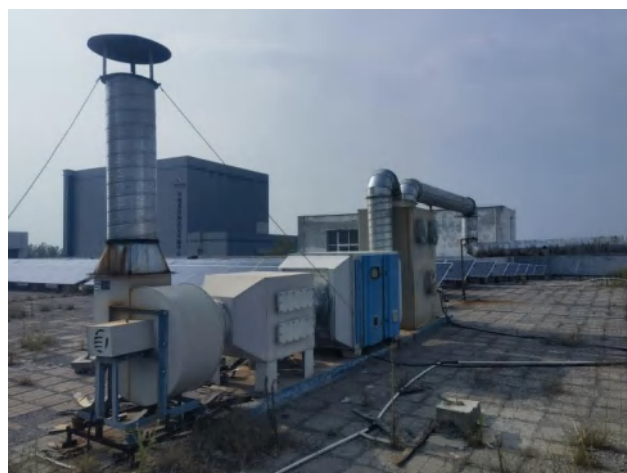
废气治理设施
