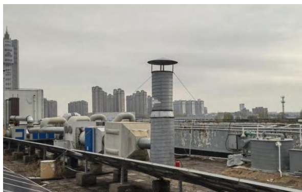
废气治理设施
