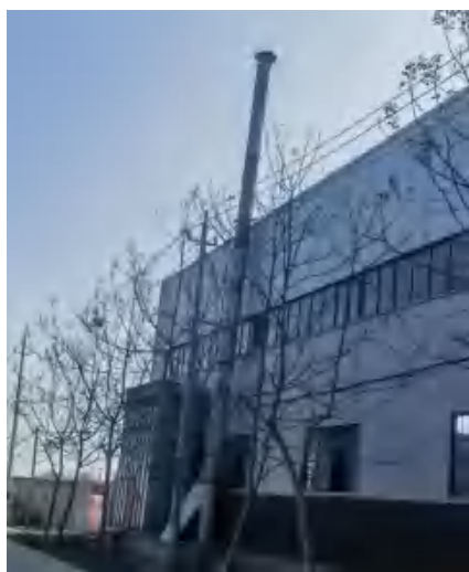
DA001 及袋式除尘器治理设施
