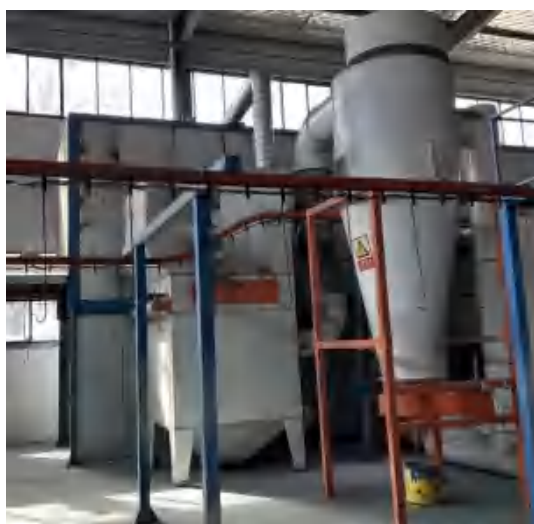
喷粉废气治理设施
