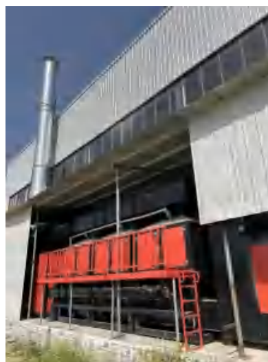
DA002 及吸附浓缩+催化燃烧治理设施
