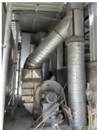
腻子打磨废气治理设施
