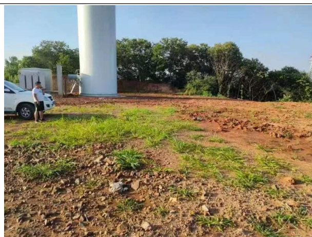
部分风电机组基座植被恢复 1
